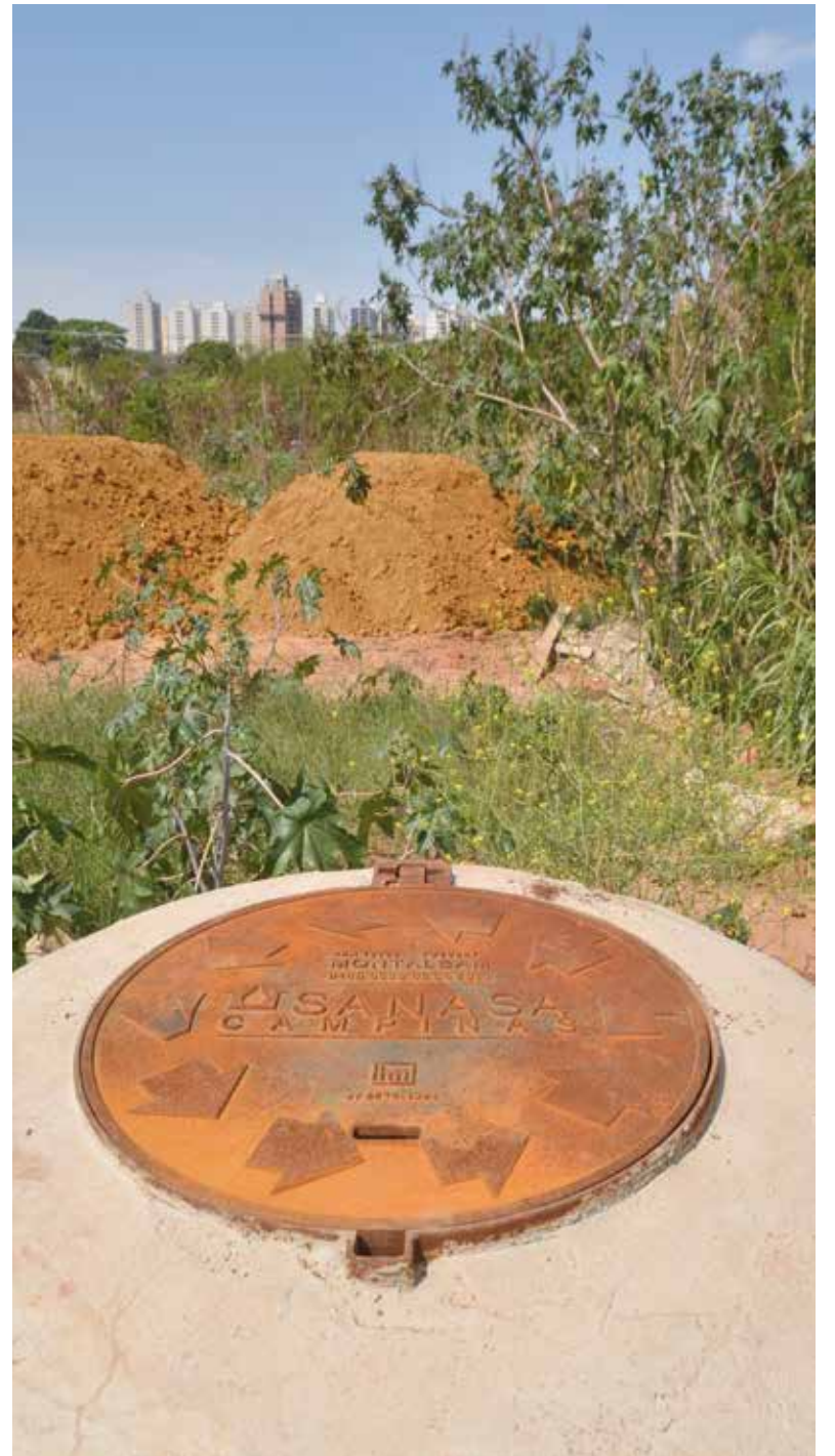
Caixas coletoras ao longo do percurso da rede já estão prontas para serem utilizadas
