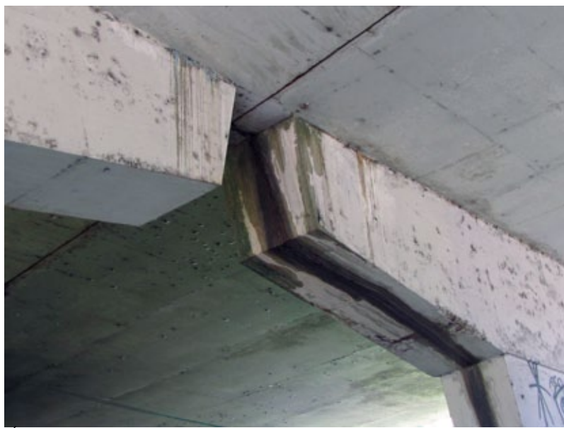
Água escorre permanentemente pelas colunas dos viadutos, mesmo depois das chuvas
