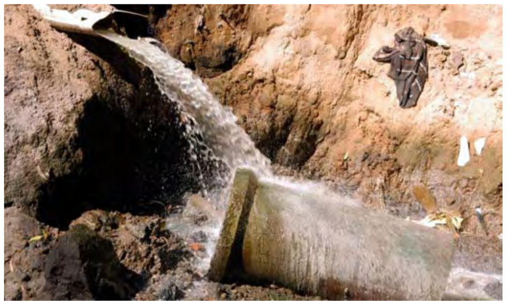
Esgoto em cascata a céu aberto, na Hermantino Coelho, traz mal cheiro e risco à saúde
